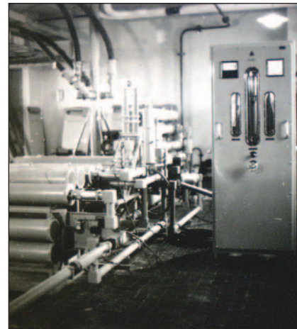
9. ábra. Az 50 kW-os vízűtéses műantenna szekrénye. A 4 db, toronyba menő koaxiális kábel külső átmérője 14 cm (75 ohm)
